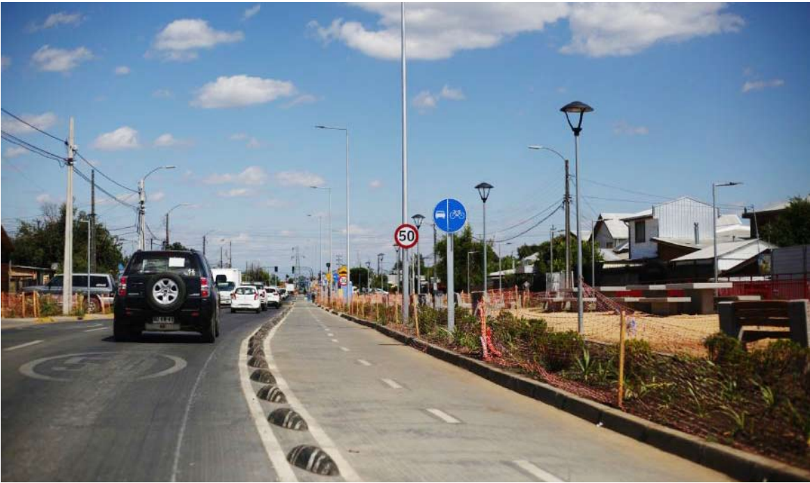
La conexión a semáforos, junto a obras peatonales, se cuentan entre los trabajos faltantes.
