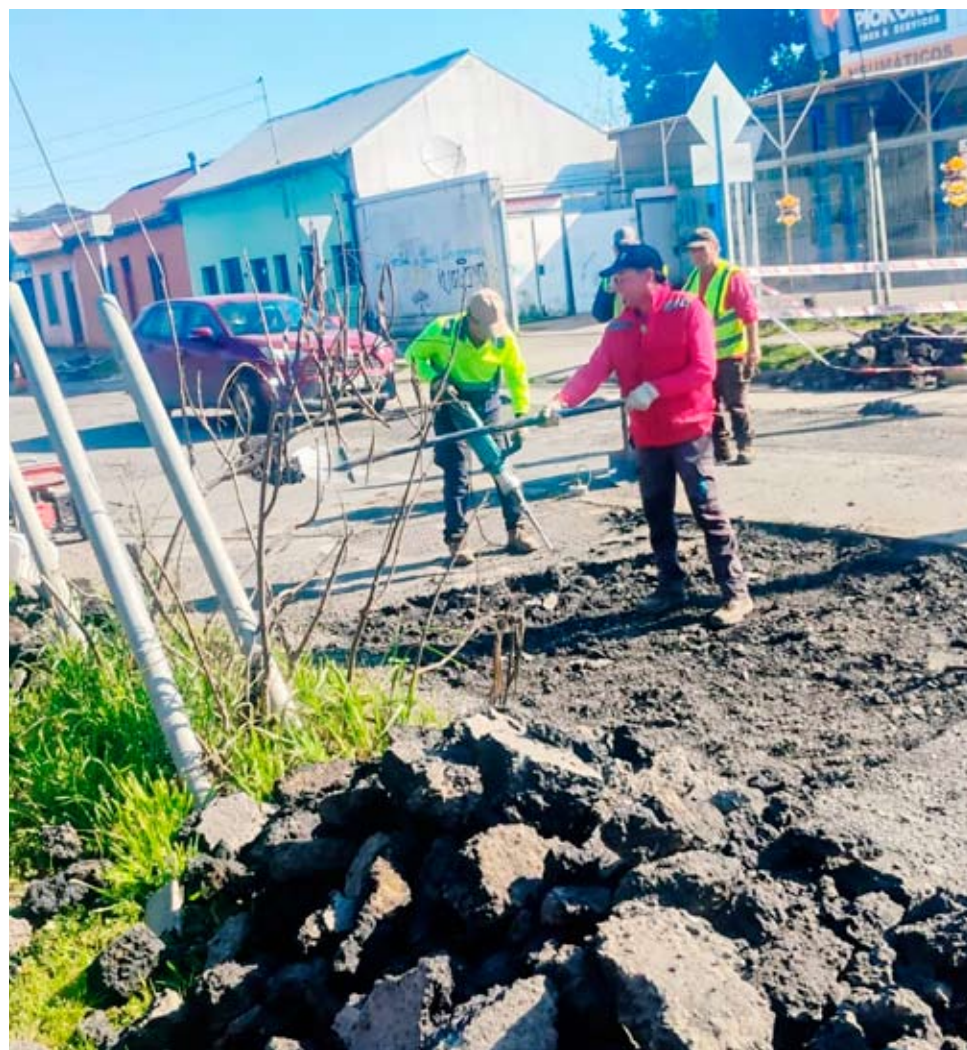
La intersección de Sargento Aldea con Ecuador fue una de las más dañadas tras las lluvias.
