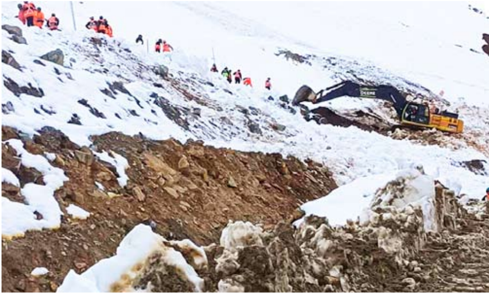
Personal de emergencia de Codelco mantiene las labores de búsqueda y localización.
