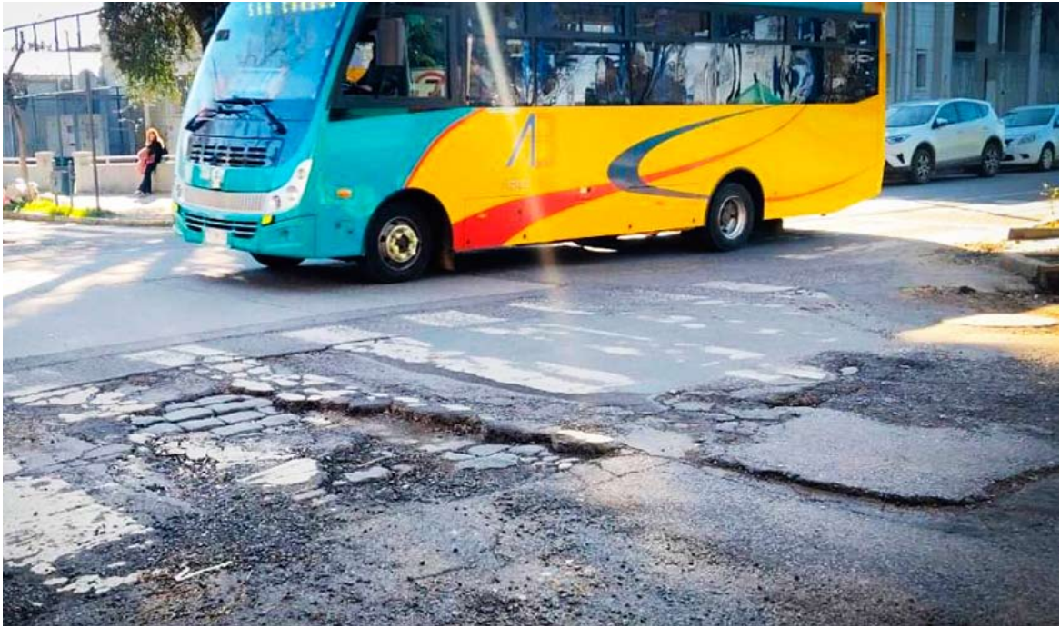
Baches representan un riesgo para los conductores y sus vehículos.
