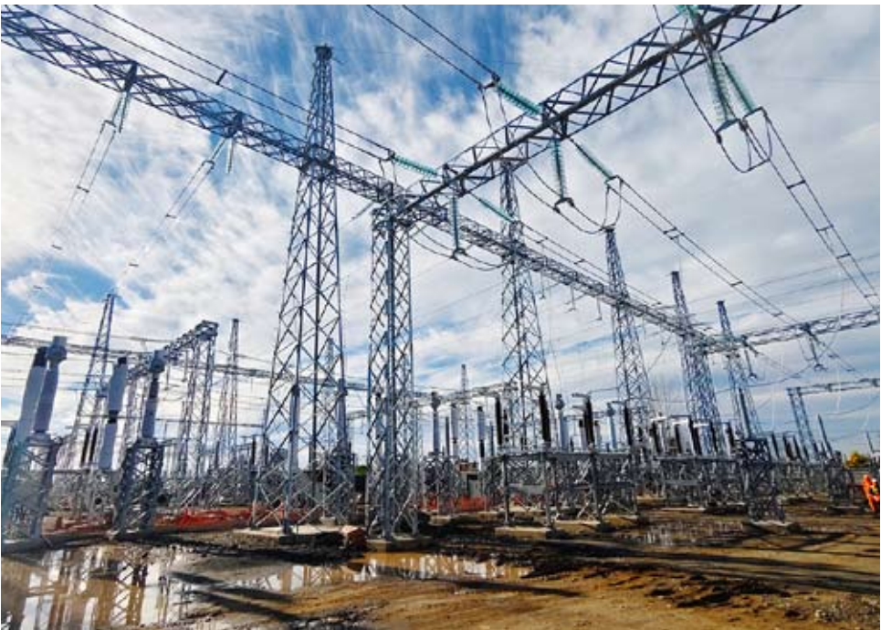
Se destaca que Buli va a generar un alivio en la red de transmisión en la zona norte de la región.
